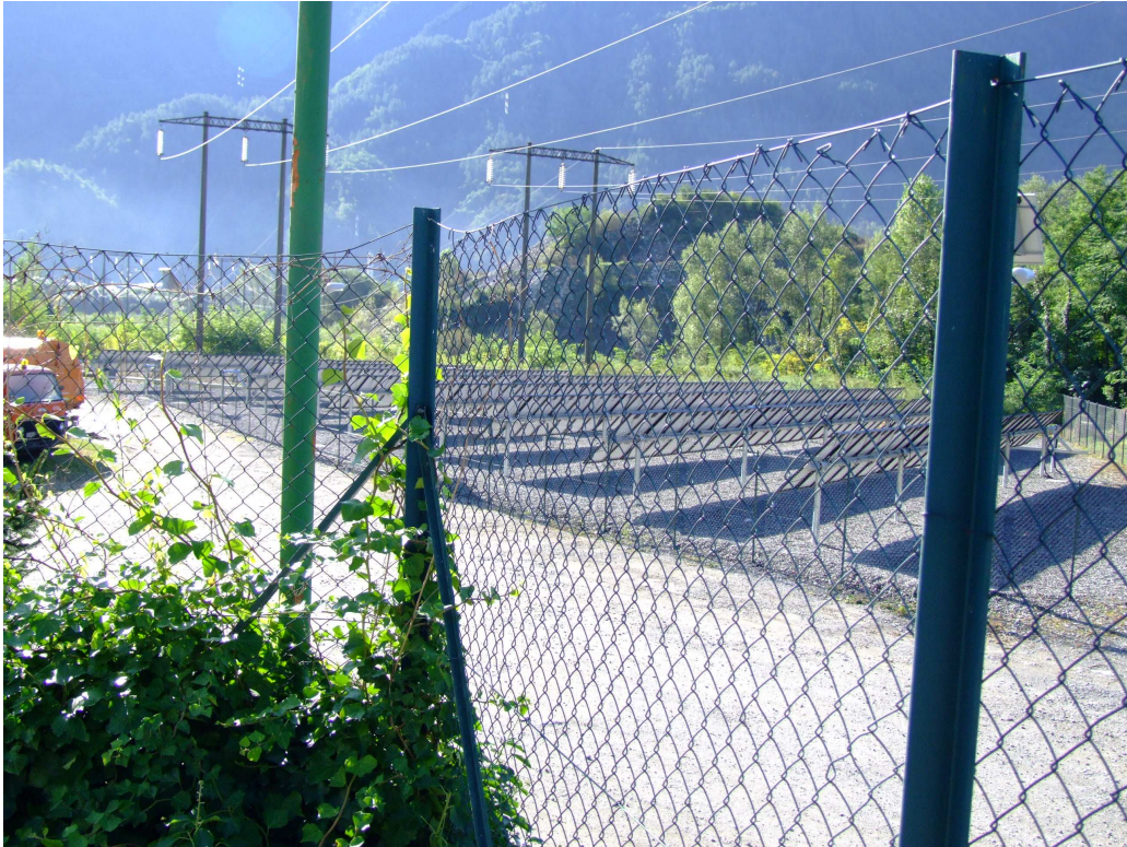
Foto 5: vista verso sud – impianto fotovoltaico
